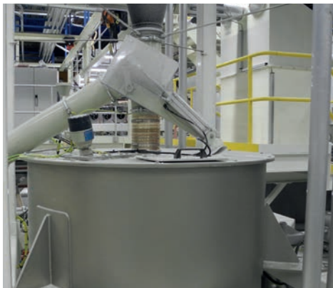
Afb. 2 De MicroTrek geleide radar niveaumeter van Nivothem steekt aan de linkerkant schuin door het silodak
